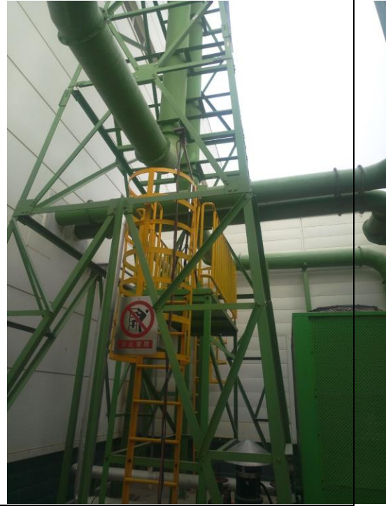
抛丸机废气处理前采样口 1#
