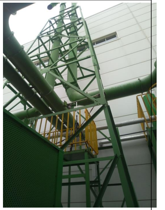
抛丸机废气处理前采样口 2#
