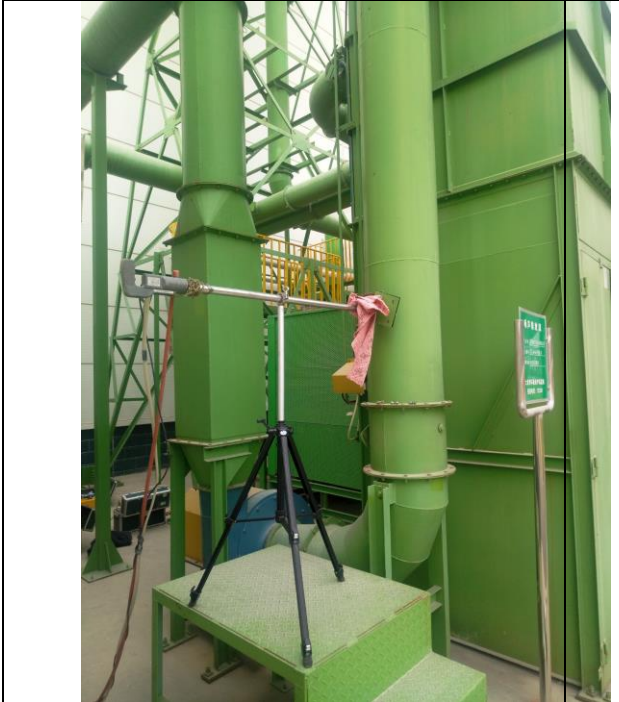
抛丸机废气处理后排放口 1#
