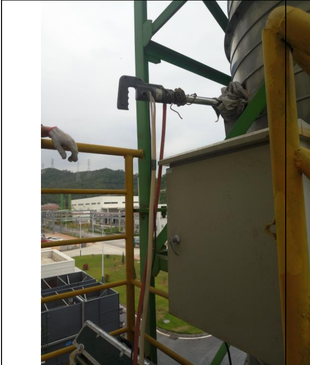
锻造机废气处理后排放口
